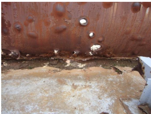
Slika 3 – Oštećenja na omotaču rezervoara
