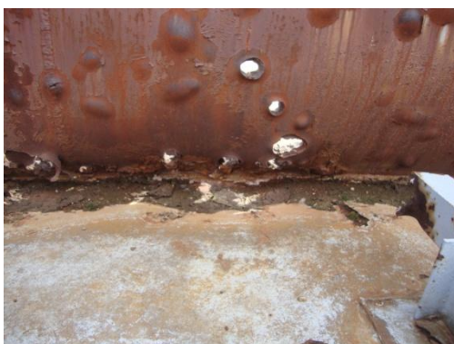
Slika 3 – Oštećenja na omotaču rezervoara
