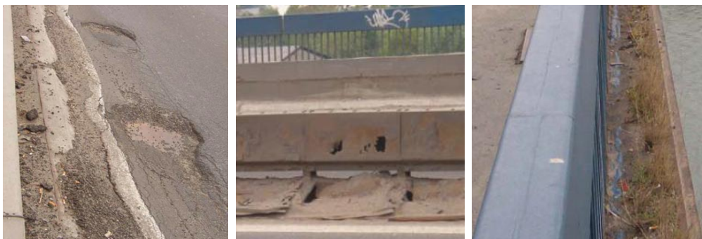
Slika 3: Oštećenja saobraćajnog profila
