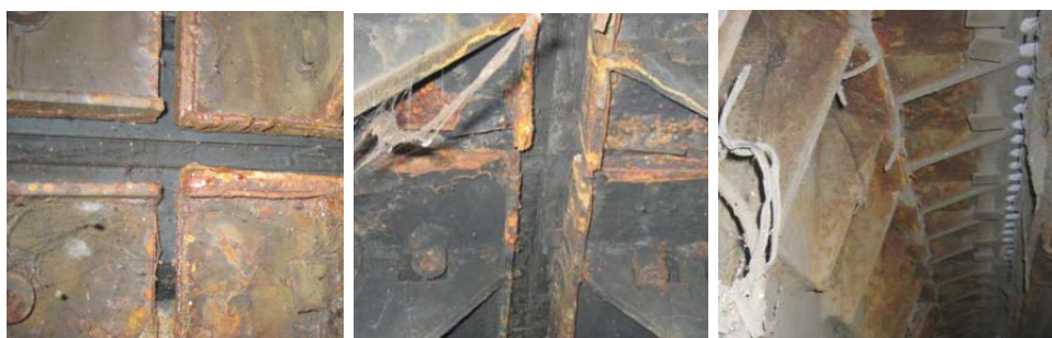
Slika 7: Oštećenja dilatacionih spojnica
