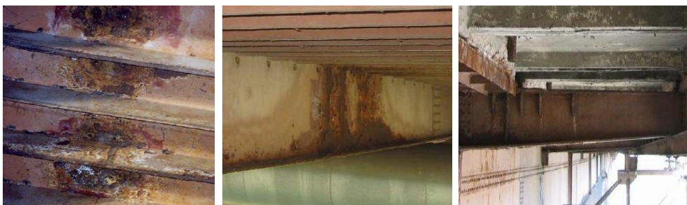
Slika 6: Oštećenja spoljne površine sanduka mosta i pešačkih staza
