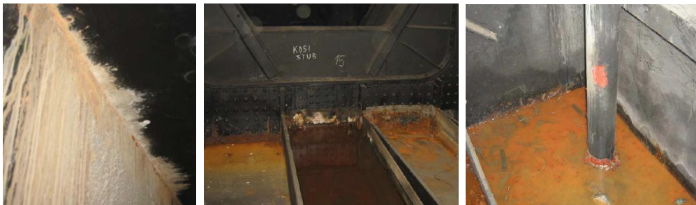
Slika 4: Oštećenja unutar sanduka mosta
